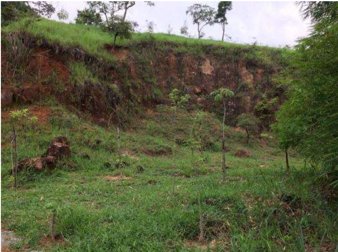
Figura 37 - Plantios de álamos e espécies florestais nativas para a criação de uma cortina verde em frente à erosão Fonte: Gos Florestal, dezembro 2016
