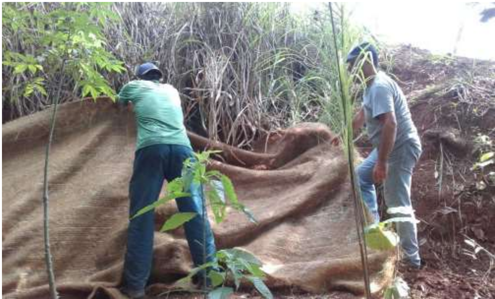
Figura 15 - Instalação de biomantas para contenção de processos erosivos no entorno da nascente. Fonte: Gos Florestal, dezembro 2016
